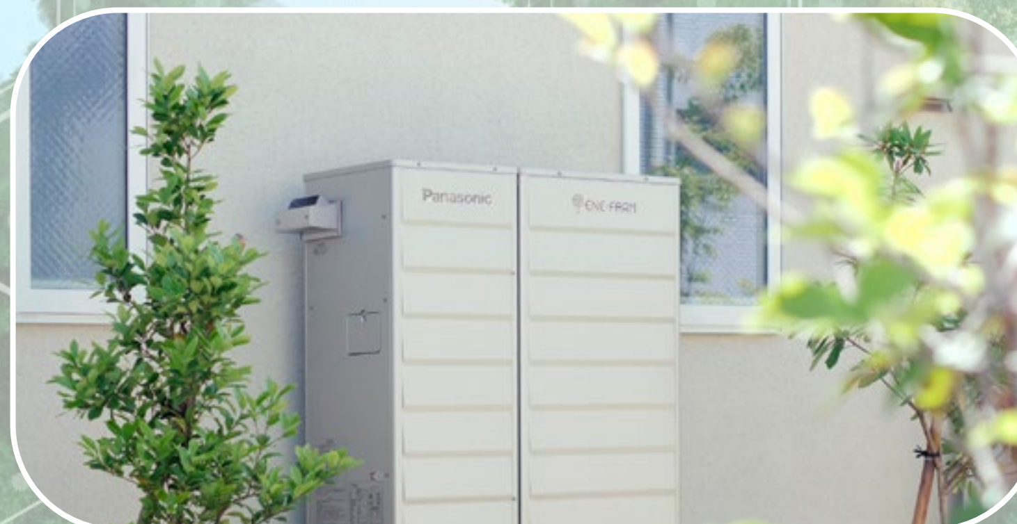
Pile à combustible pour l'habitat ENE-Farm (Panasonic) au Japon.
